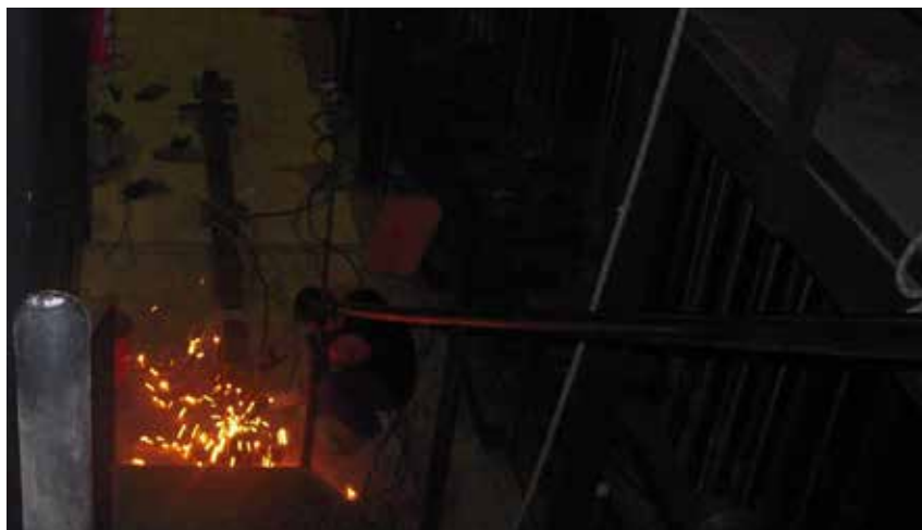
Obras no supervisadas de remodelación o mantenimiento del edificio del museo en las que se usan llamas abiertas o otras fuentes de calor o chispas representan un importante riesgo de incendio (Foto: José Luiz Pedersoli Jr.).
